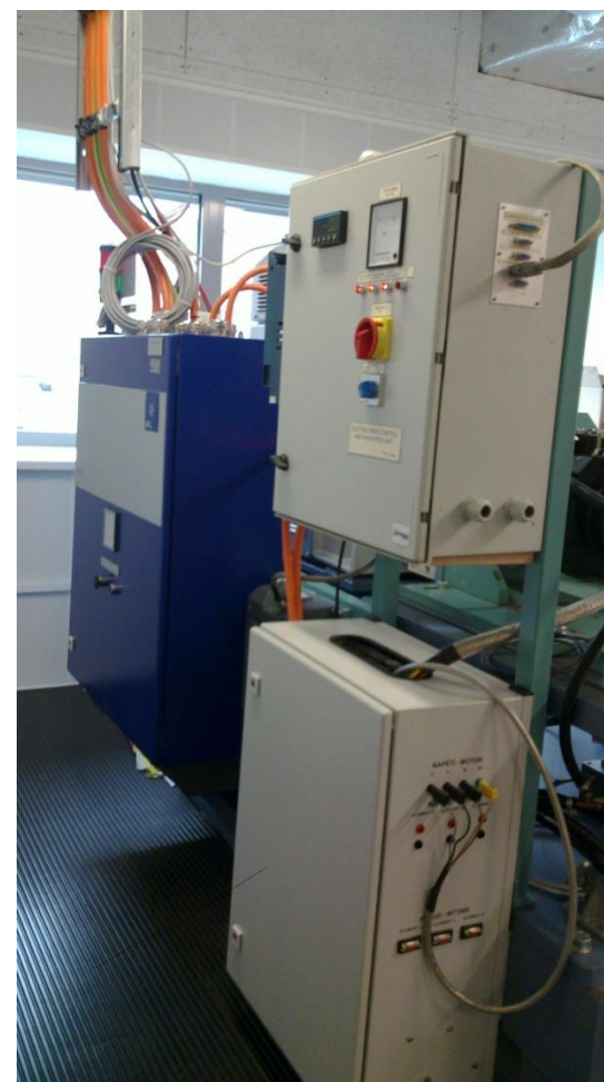
Měřicí stanoviště adaptované na motor 28 kW
